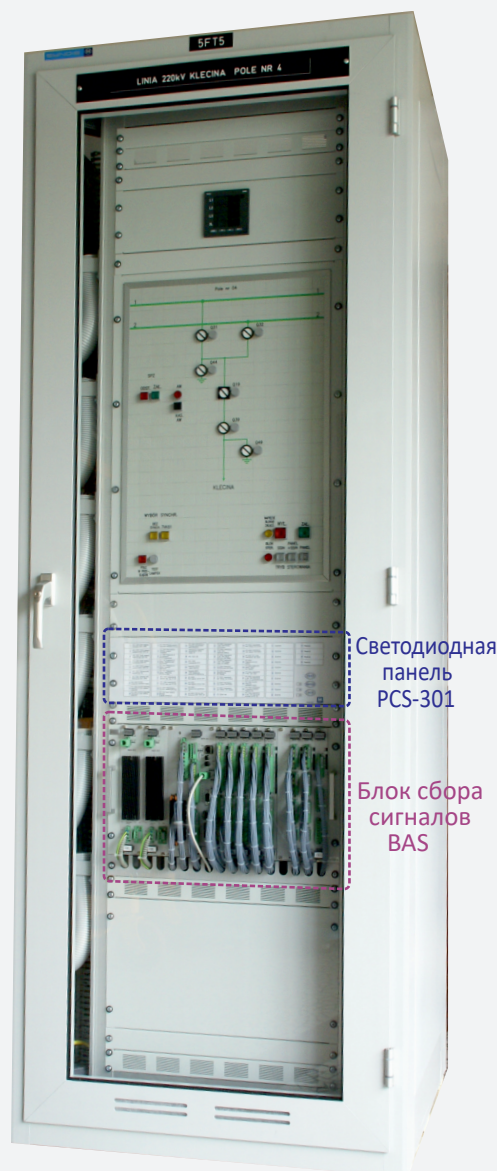
PCS-301 в шкафу сигнализации
